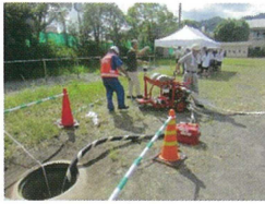
▲マンホール・可搬ポンプ
