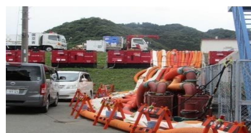
ポンプ・配管
