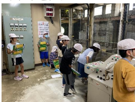
ゴミピットからクレーンで焼却炉の中にゴミを入れるところを見学
